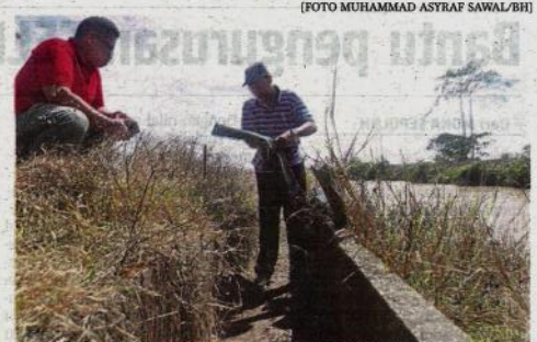
Mohd Derus menunjukkan saluran air yang tidak diselenggara dengan baik oleh pihak berkuasa di Pahang Tua, Pekan, semalam.
