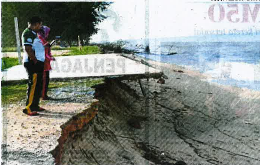
HAFIFI meninjau hakisan pantai di Pantai Pengkalan Maras.
