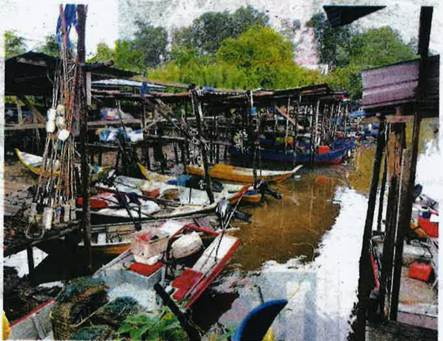
JETI nelayan di Sungai Che Rahmat, Trong dekat Taiping akan dibaik pulih kerana terlalu uzur dan tidak selamat digunakan.
