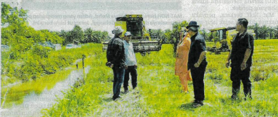
TAJUDDIN (dua dari kanan) bersama wakil beberapa jabatan berkaitan mengadakan lawatan di tapak pembinaan tali air konkrit yang terbenkakai di Sungai Manik, Pasir Salak baru-baru ini.
