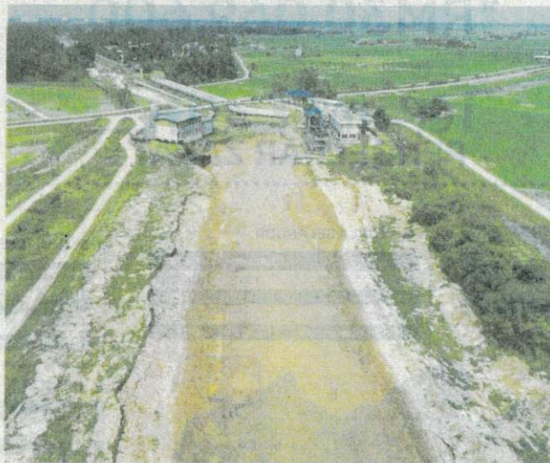
Paras air Sungai Muda di Pulau Pinang menurun dengan mendadak susulan berlaku kerosakan pintu kawalan air Sungai Muda.
