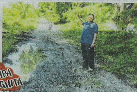
Mohd Zulhailmi menunjukkan keadaan laluan alternatif yang rosak tetapi terpaksa digunakan penduduk selepas jambatan runtuh.
