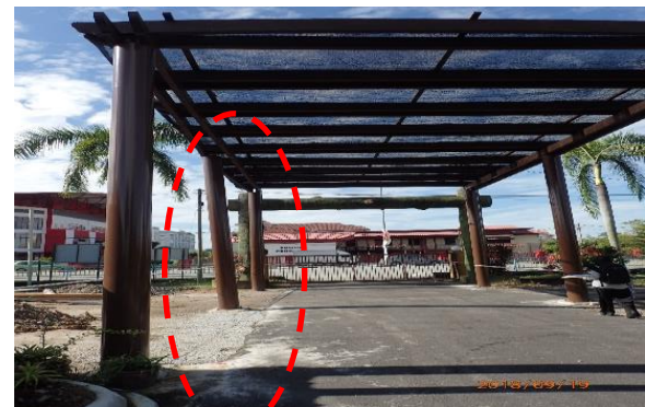
Kerosakan Pada Struktur Pergola Kayu Di Laluan Masuk Utama
