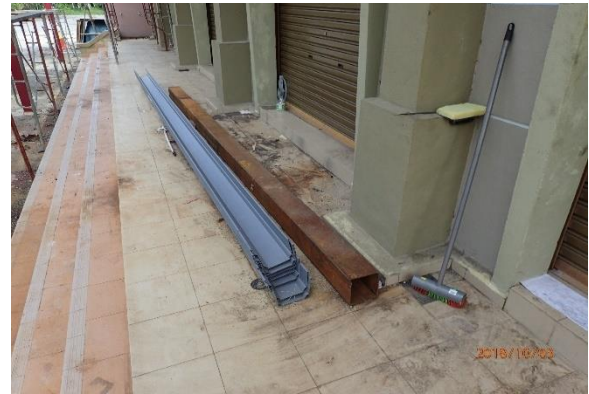
Gutter PVC Yang Masih Belum Dipasang
