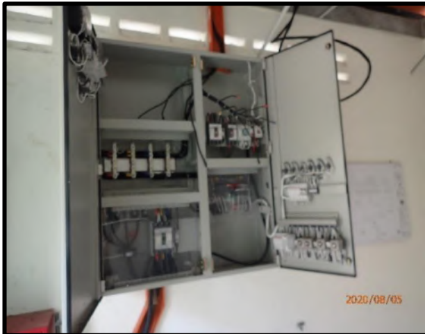
Distribution Board Yang Telah Dirosakkan Untuk Mendapatkan Komponen Elektrik Lokasi: Kandang TKPR PPM Kluang Tarikh Lawatan: 5 Ogos 2020
