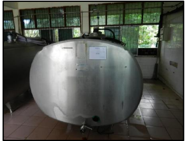
Tangki Penyimpanan Susu 3000 liter Lokasi: PPIT Sungai Tiram Tarikh Lawatan: 06.09.2020
