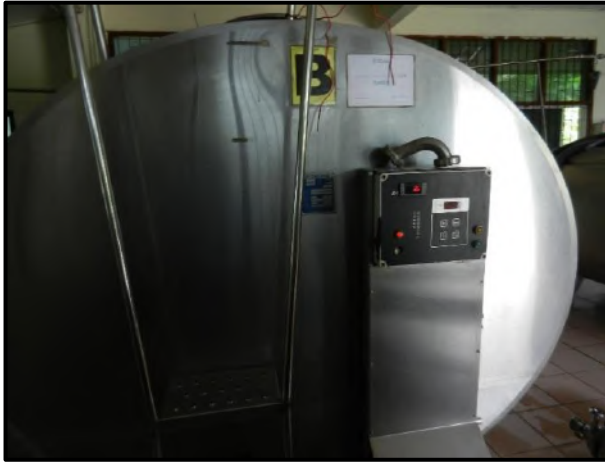
Tangki Penyimpanan Susu 6000 liter Lokasi: PPIT Sungai Tiram Tarikh Lawatan: 06.09.2020
