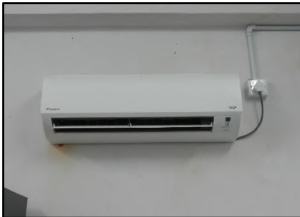
Penghawa Dingin Di Tidak ditanda dengan Hak Kerajaan Malaysia Lokasi: PPIT Sungai Siput Tarikh Lawatan: 10.09.2020
