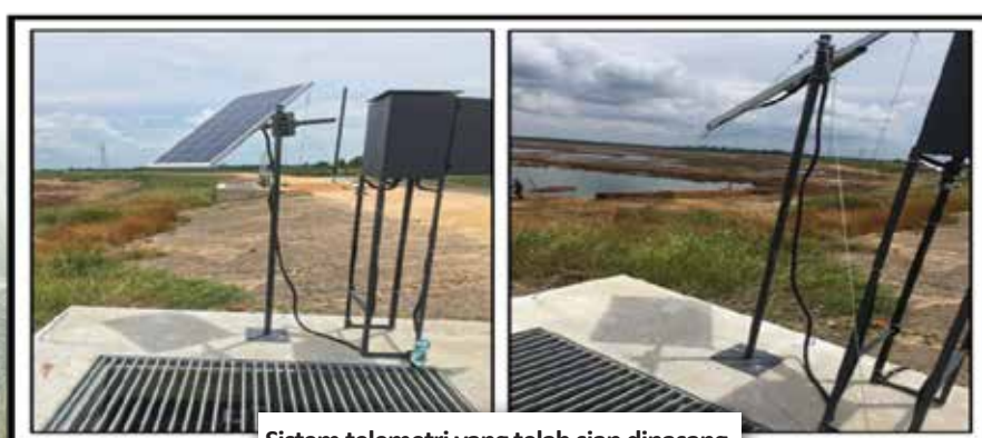
Sistem telemetri yang telah siap dipasang.
